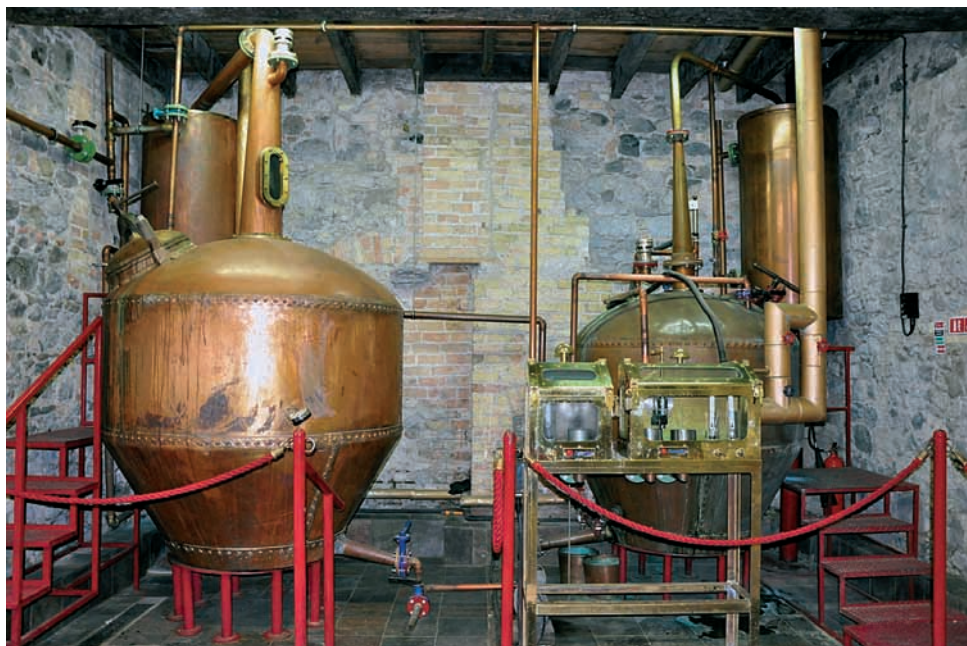
Die Destillationsanlage mit der neuen Wash Still aus Schottland (2007) und der historischen Spirit Still (wohl 1830) aus der Tullamore Distillery erlaubt die zweifache und mehrfache Destillation. Sie dient Cooley Distillery Plc ebenfalls als Testanlage.
